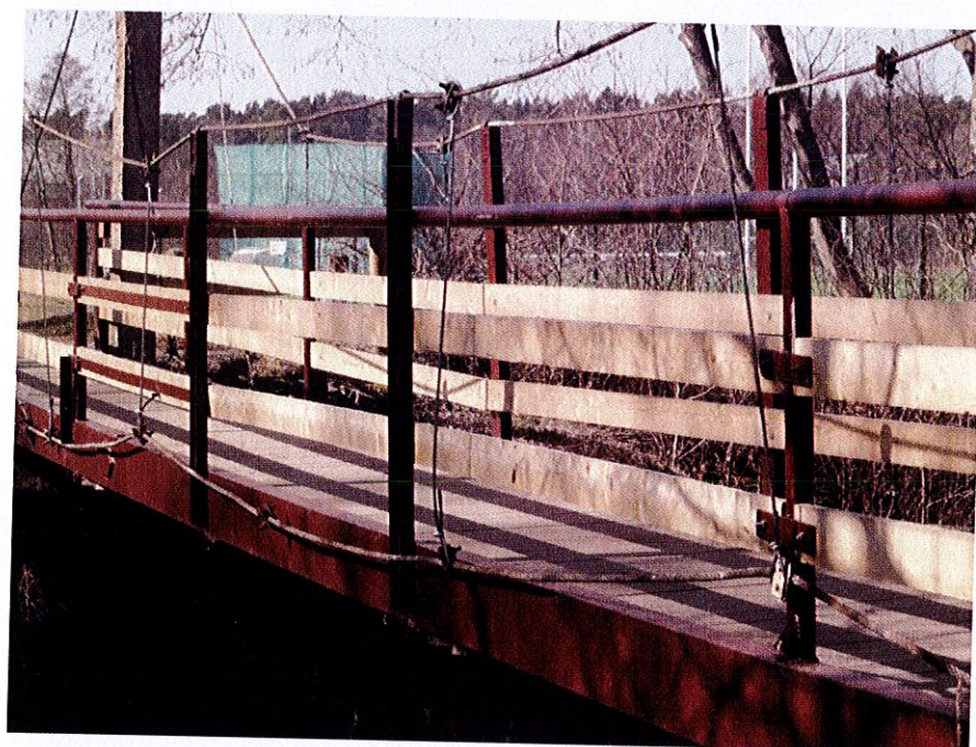
Skats uz margām. Augštece. Pakaru un trošu stiprināšana pie tilta laiduma nepietiekama nepieciemamās slodzes pārņemšanai uz galvenajām trosēm.
