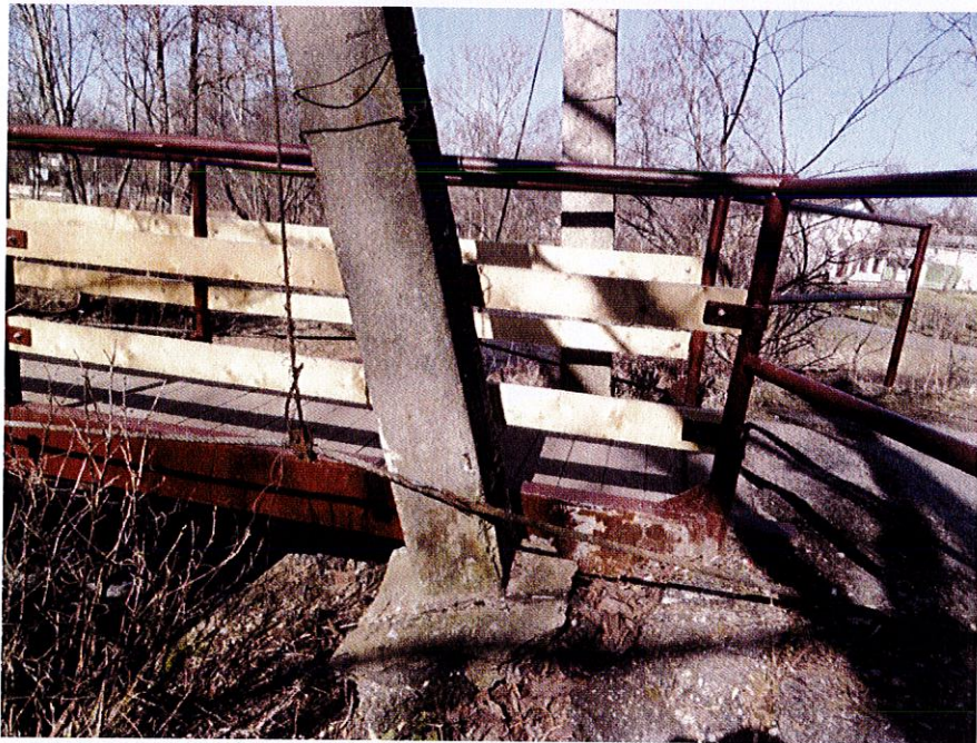
Skats uz statu ass 1-1 (augštece). Stats ir novirzījies no vertikālā stāvokļa. Atsaites trosē bojāta.
