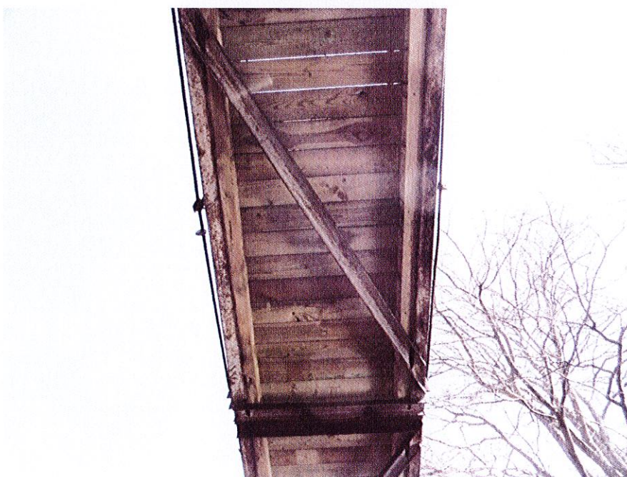
Skats uz laidumu no apakšas. Garensiju un šķērssiju korozija.
