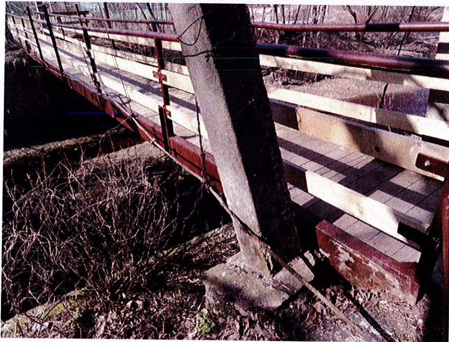
Skats uz statu ass 1-1 (augštece). Stats ir novirzījies no vertikālā stāvokļa. Atsaites trose bojāta.
