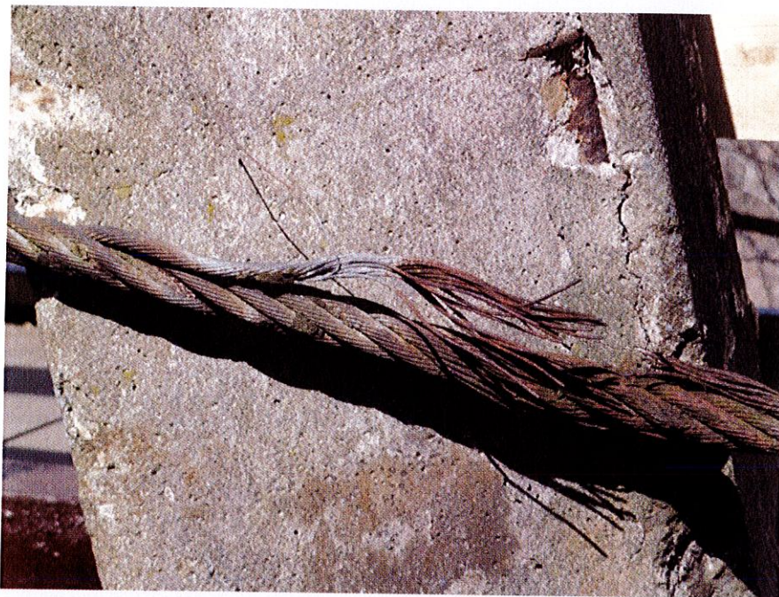
Skats uz statu ass 1-1 (augštece). Atsaites trosē bojāta.
