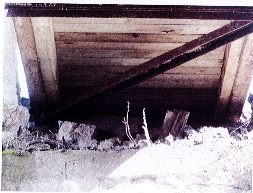
Skats uz laidumu no apakšas uz ass 1-1. Garensiju un šķērsiju korozija.
