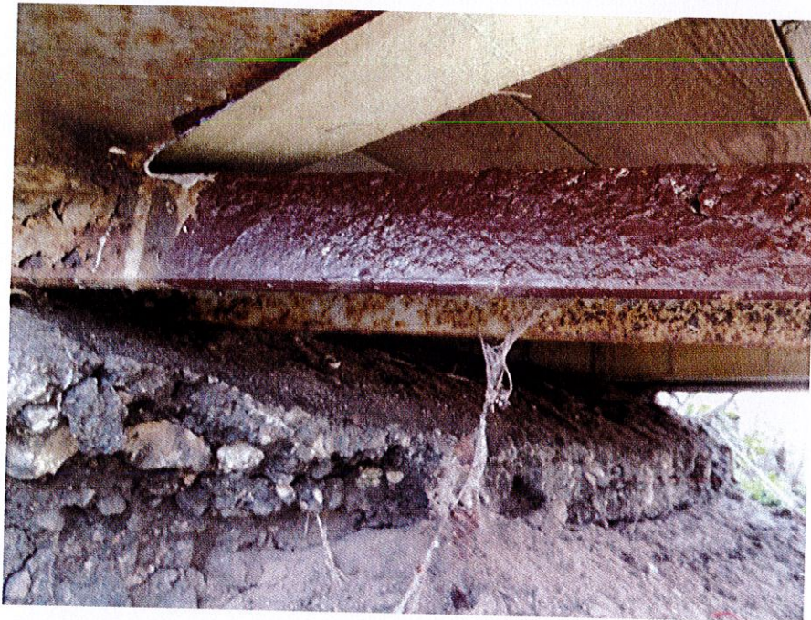
Skats uz laidumu no apakšas uz ass 2-2. Garensiju un šķērssiju korozija.
