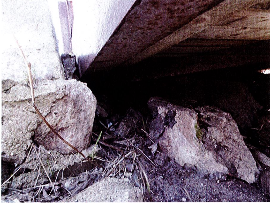
Skats uz gala balstu uz ass 1-1. Garensiju un šķērssijju korozija.
