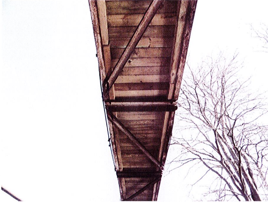
Skats uz laidumu no apakšas. Garensiju un šķērssiju korozija.
