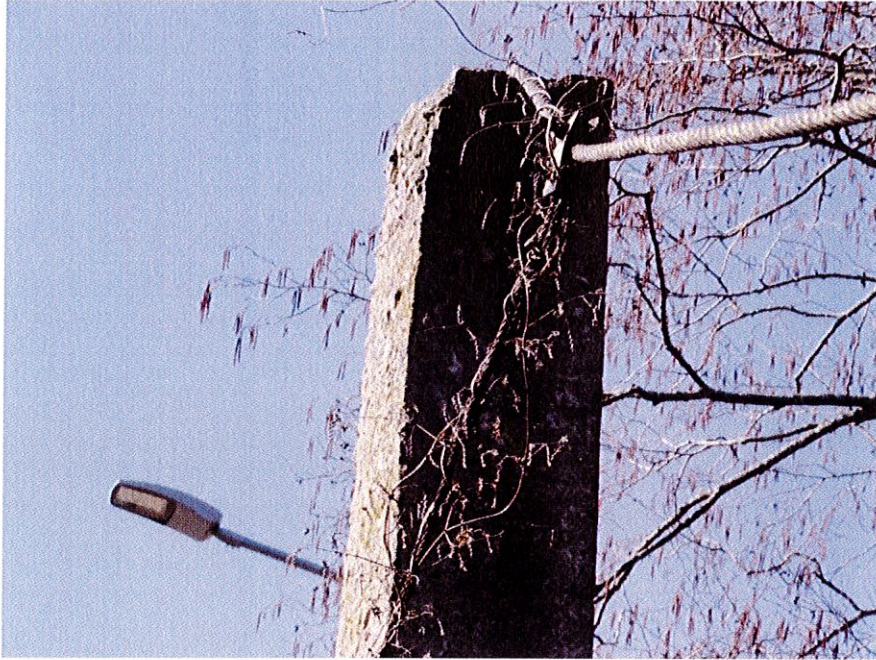
Zvejniekiema vidusskolas puse. Galveno trošu novietojums virs stata neatbilstoši izpildīts- trosei nav iespējas pārvietoties bez mehāniskiem bojājumiem statam vai trosei.
