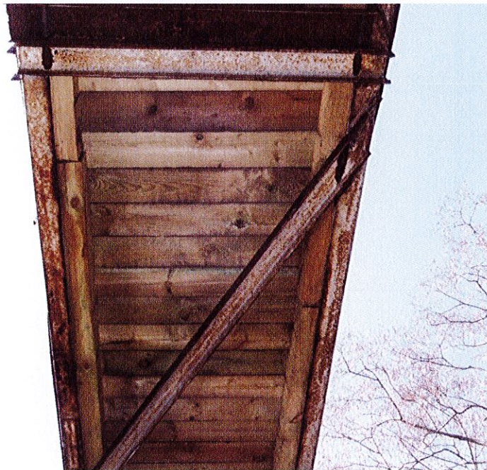
Skats uz laidumu no apakšas. Garensiju un šķērssiju korozija.
