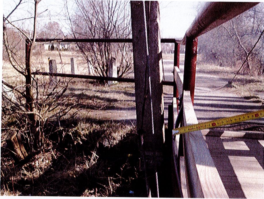
Skats uz statu ass 1-1 (lejtece). Stats ir novirzījies no vertikālā stāvokļa.
