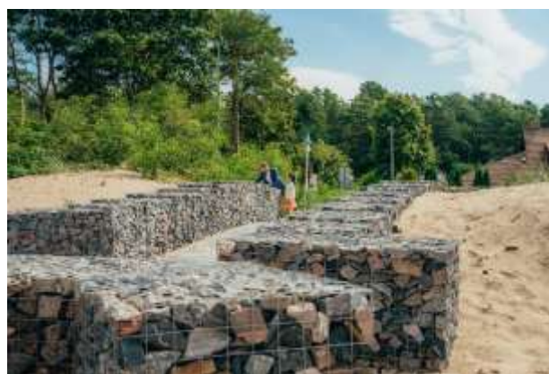
23. attēls. Projektā “Infrastrukturā izbūve pludmalē pie stāvlaukuma Raiņa ielā” izbūvēta gabionu siena kāpu aizsardzībai
